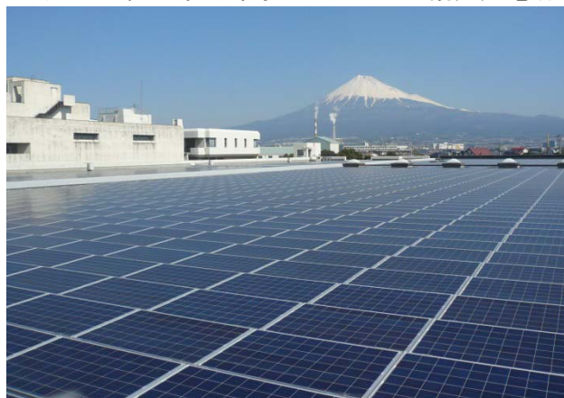
■竣工した富士市西部浄化センター太陽光発電所
