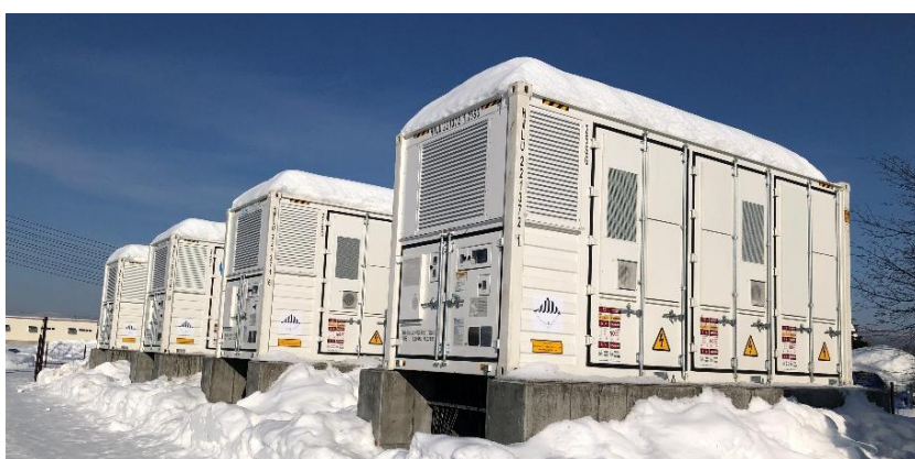
名寄 1 蓄電所の外観
